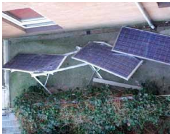
Een volledig van het dak gewaaid zonnestroomsysteem
